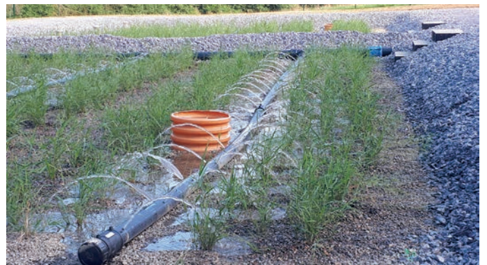
Arrivée de l'eau dans l'un des 2 bassins du 2 e étage avant d'être rejetée.
