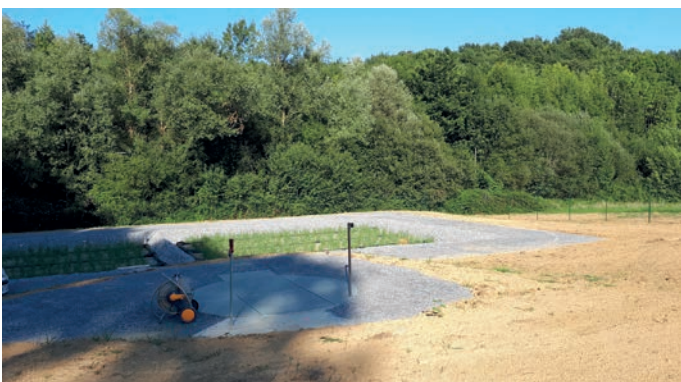
Grille sur le 2 e collecteur du 2 e étage
