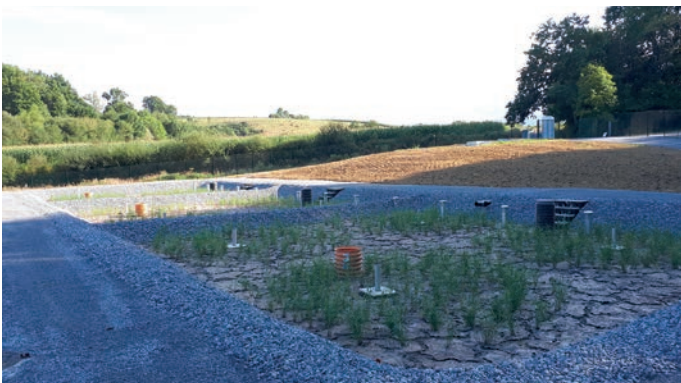
Le 1 er étage composé de 3 bassins, la croute s'est formée
