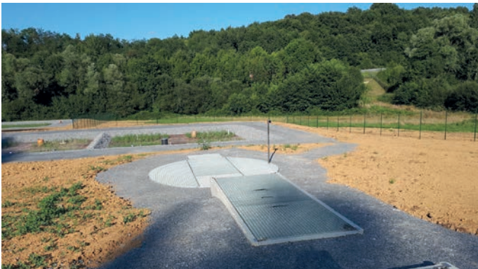
Grille sur le 1 er collecteur - Arrivée des eaux souillées
