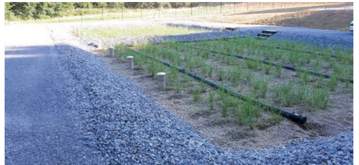
Les deux bassins composant le 2 e étage et dernier filtre
